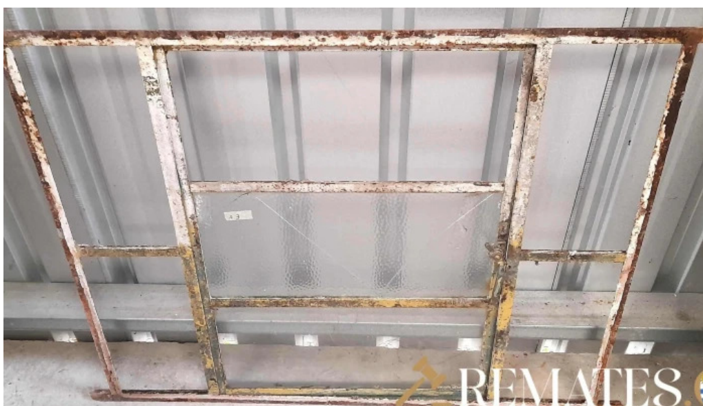
Ventana de hierr de 7 viidrio 1
