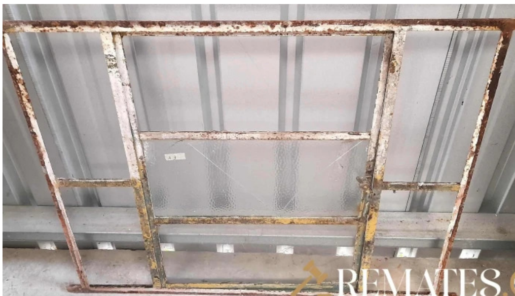
Ventana de hierr de 7 viidrio 17 06 2021
