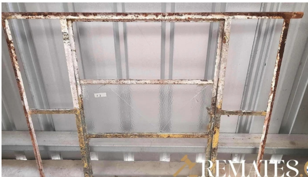
Ventana de hierr de 7 viidrio 2
