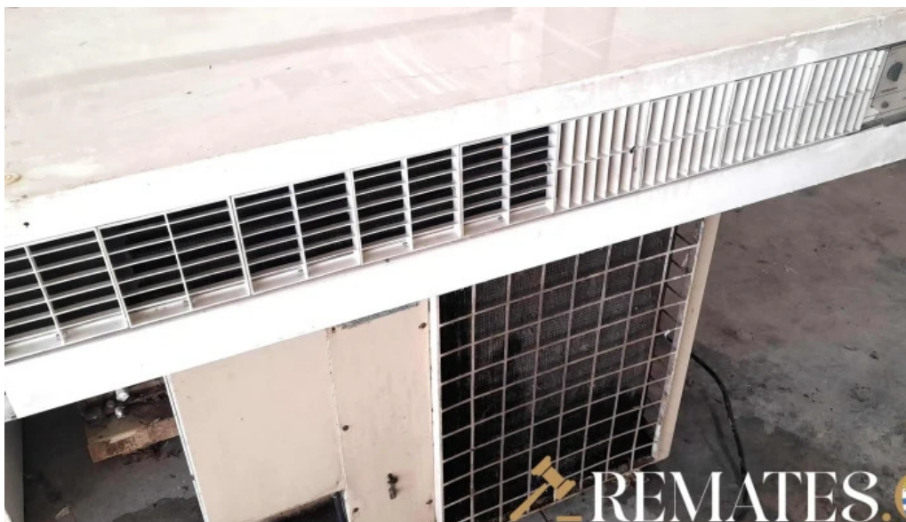
Aire acondicionado de comercio 1
