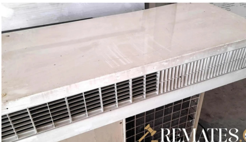
Aire acondicionado de comercio 2
