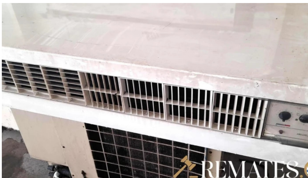
Aire acondicionado de comercio 3
