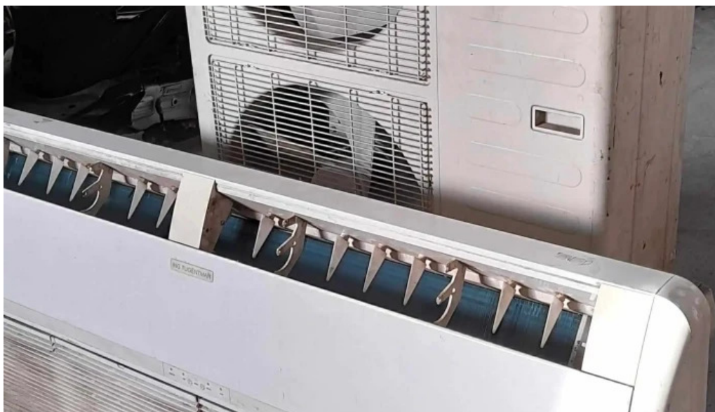
Aire acondicionado de 60000 btu 1
