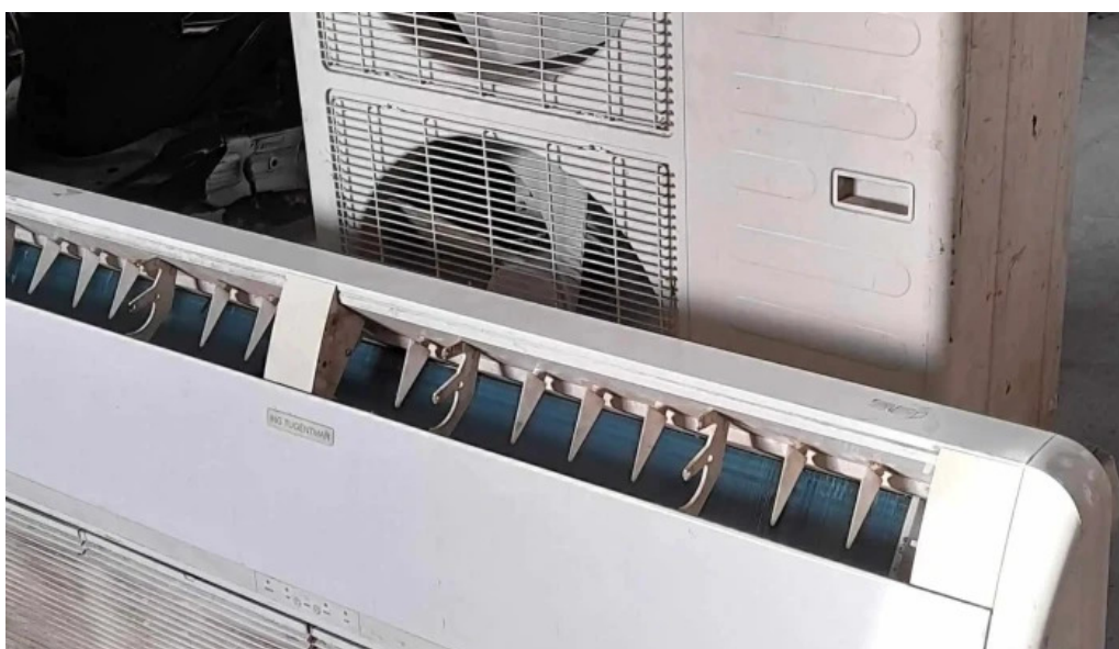
Aire acondicionado de 60 000 btu 17 06 2021
