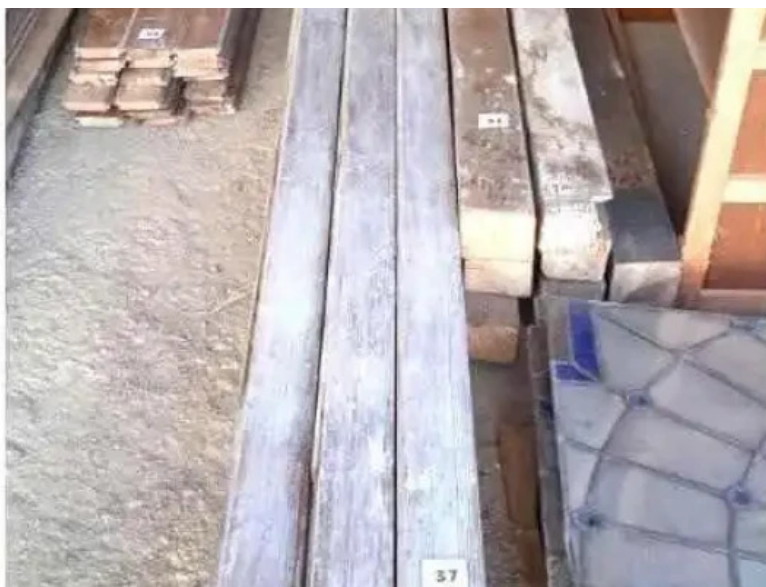
10 m2 piso de pinotea con picaduras de polilla 13 03 2021
